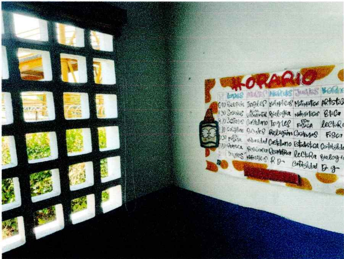
Fotografía 5. Condición de muros interiores y elementos de ventilación.
